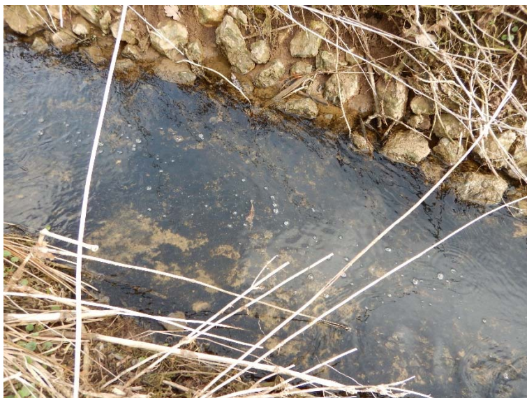
Abbildung 10: strukturarmer Verlauf des Ortsbaches mit befestigtem Böschungsfuß, einheitlichem Profil und starkem Algenaufwuchs (dunkle Schicht) (Abschnitt 3-5)
