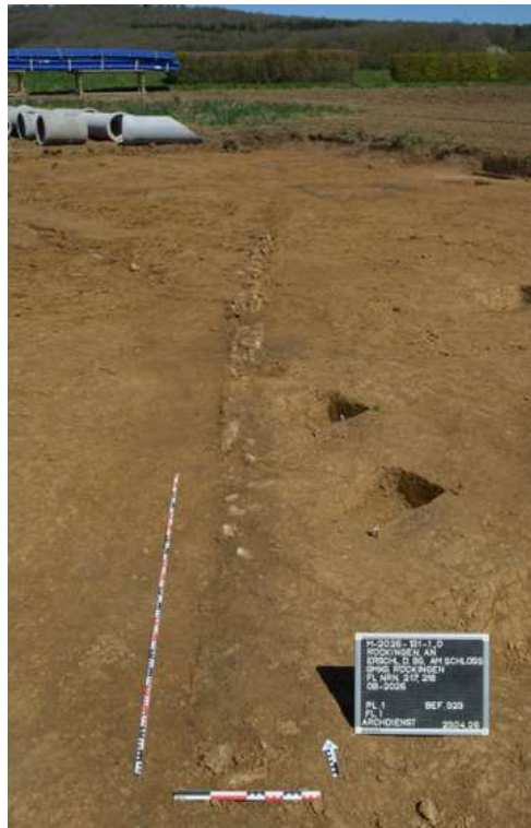
Abb. 11: Eine mit Steinen gefüllte Drainage(?) (hier Bef. 323) zeigte sich in der östlichen Erschließungsstraße.
